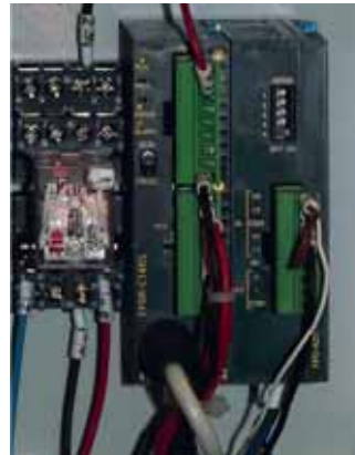
Il PLC Panasonic FP0R comanda la pompa di regolazione
